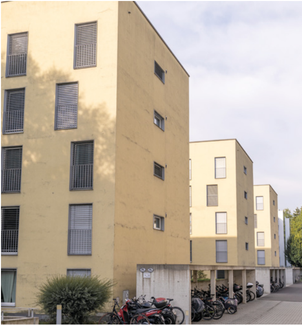
Certaines parties de la façade de l'immeuble d'habitation à Lucerne présentaient des dommages.
